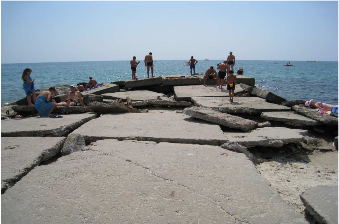
Рис. 3. Разрушение головной части буны Fig. 3. Destruction of the head of the groyne
